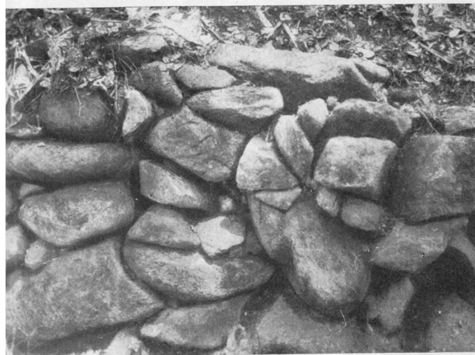
VI — Pueblito: arriba: canal de desagüe derrumbado; abajo: detalle de una muralla de contención.
