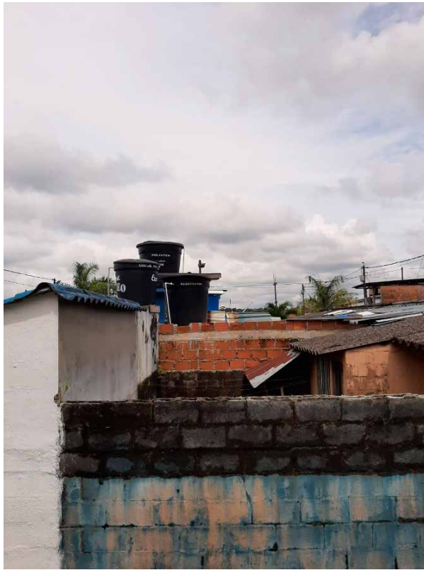
Figura 2. Tanques de almacenamiento
